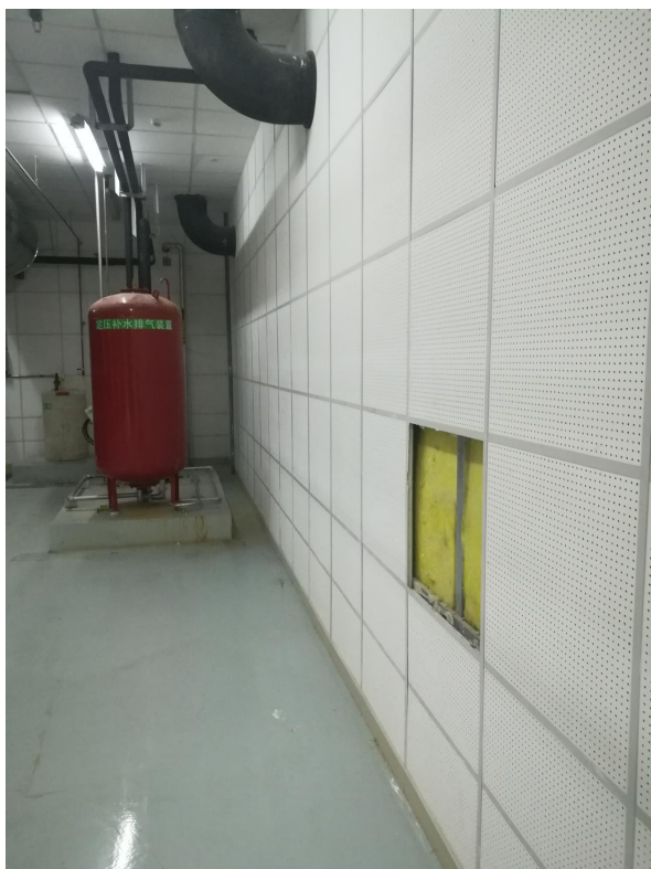
地下设备间吸音板
