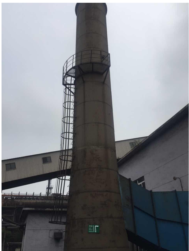
地面除尘站推焦烟气排气筒
