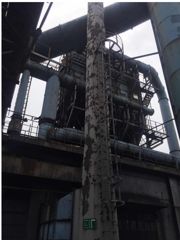
地面除尘站装煤烟气排气筒 1#
