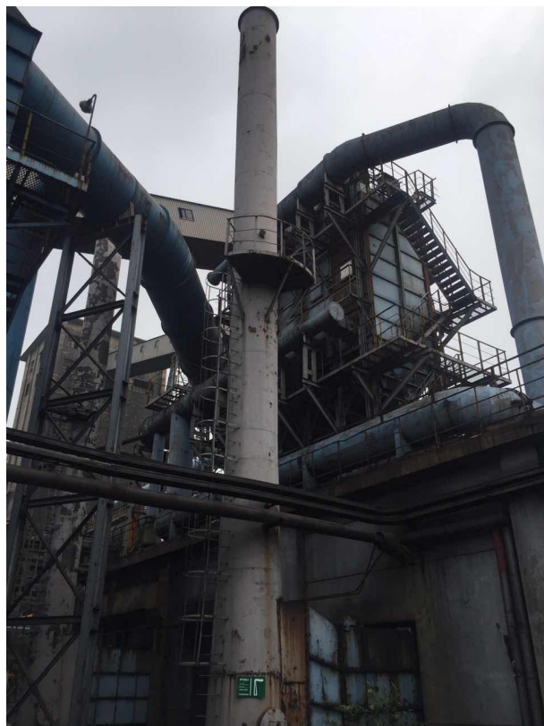
地面除尘站装煤烟气排气筒 2#
