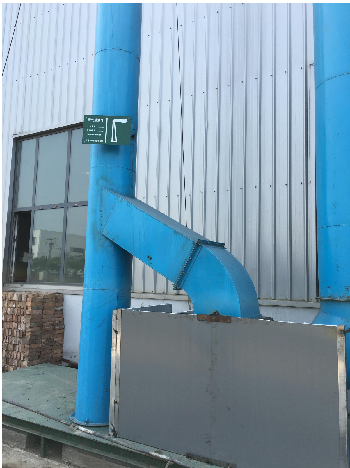
附图 4.2 抛丸工序废气排气筒 2#废气排放筒规范化
