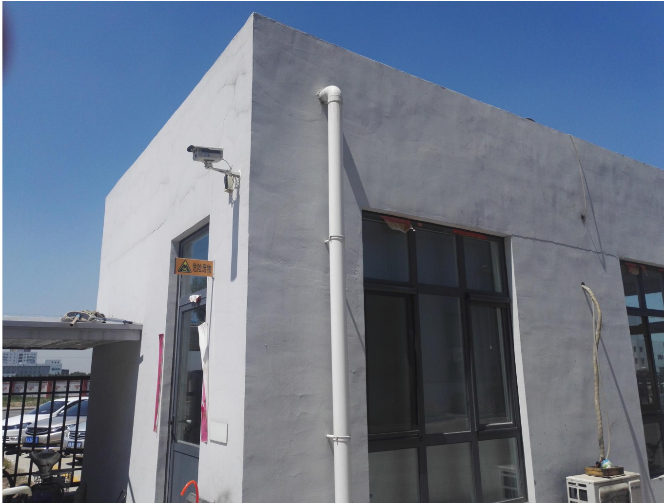
附图 4.8 危险废物暂存处
