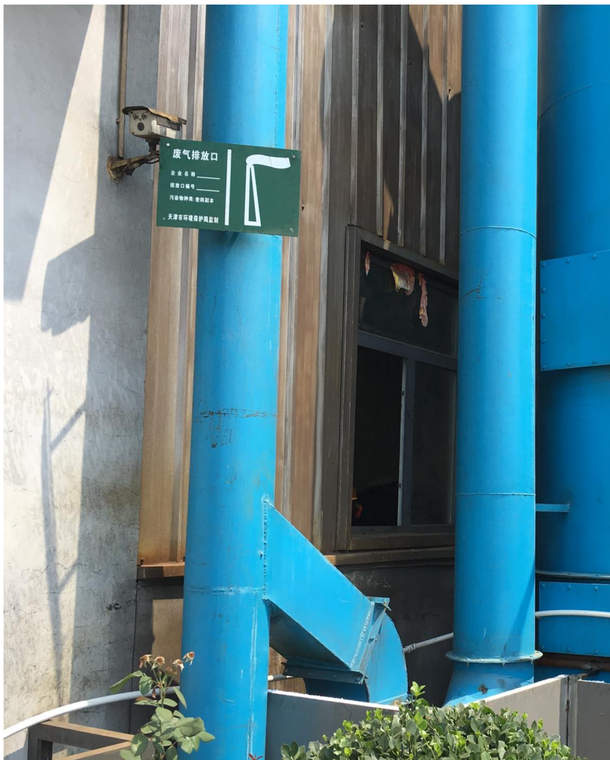
附图 4.1 抛丸工序废气排气筒 1#废气排放筒规范化
