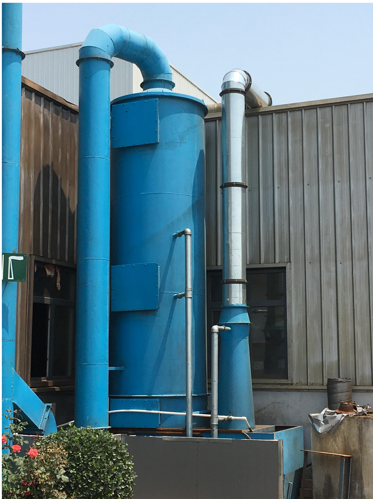
附图 4.4 FD 湿式高效净化器（抛丸工序废气排气筒 1#）
