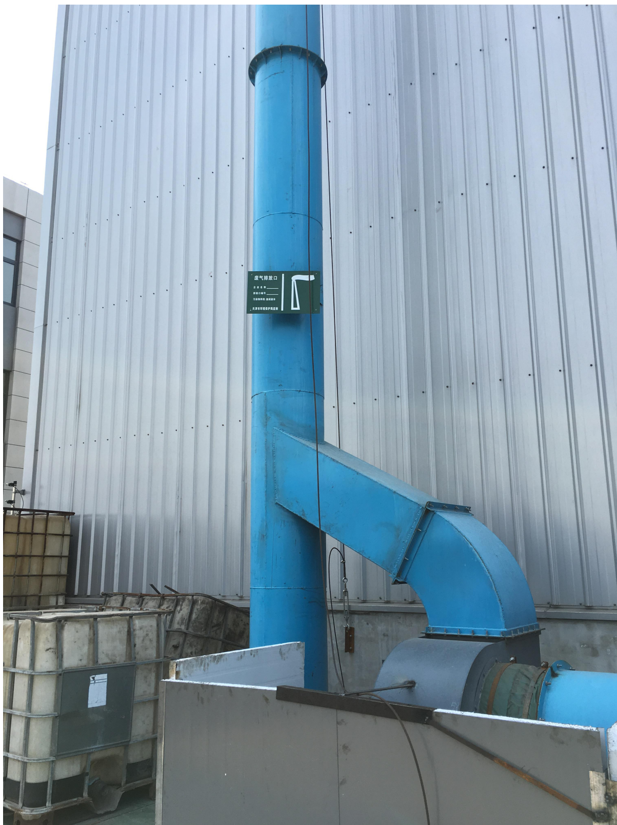
附图 4.3 冷轧工序废气排放筒废气排放筒规范化
