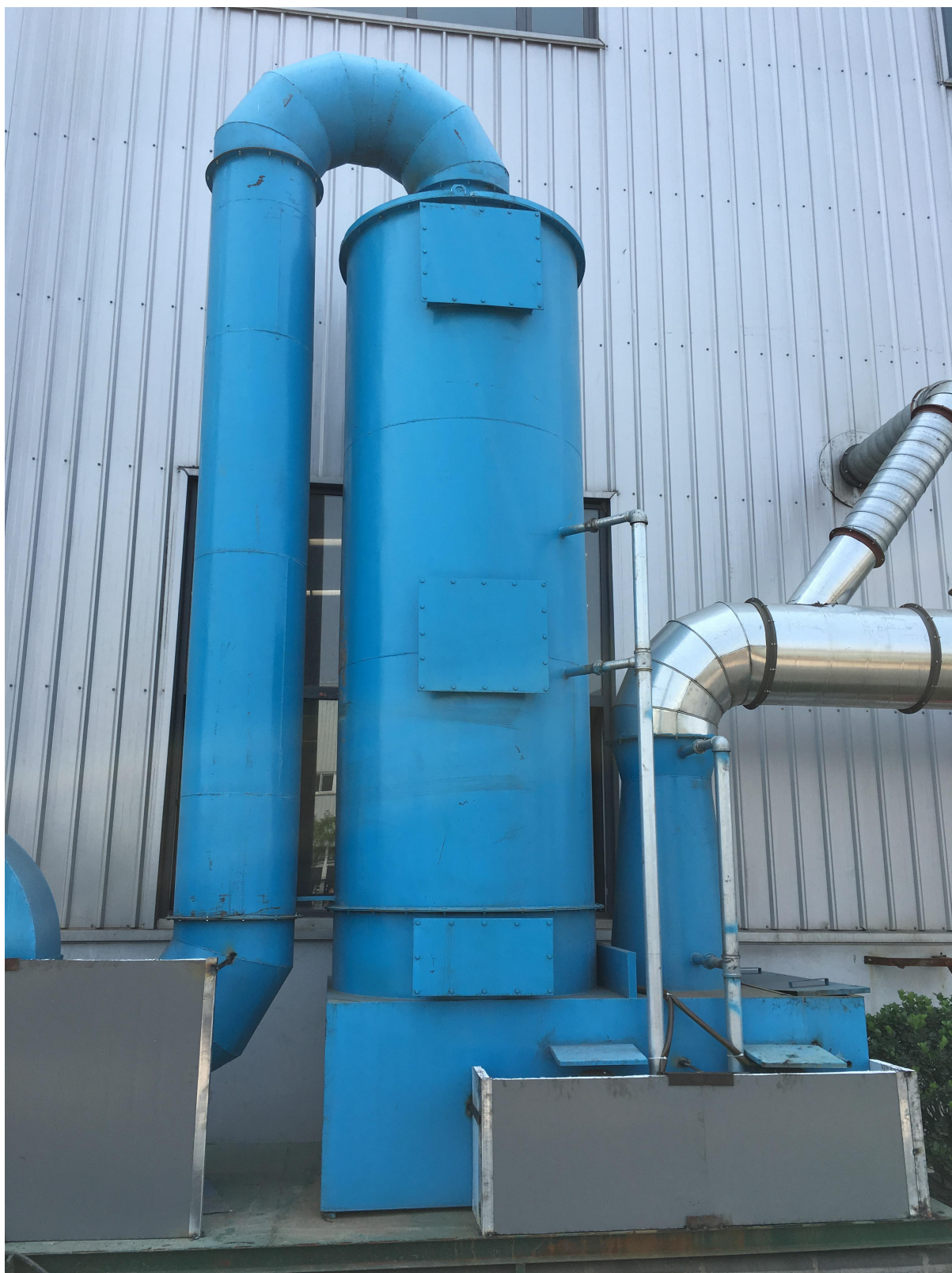
附图 4.5 FD 湿式高效净化器（抛丸工序废气排气筒 2#）
