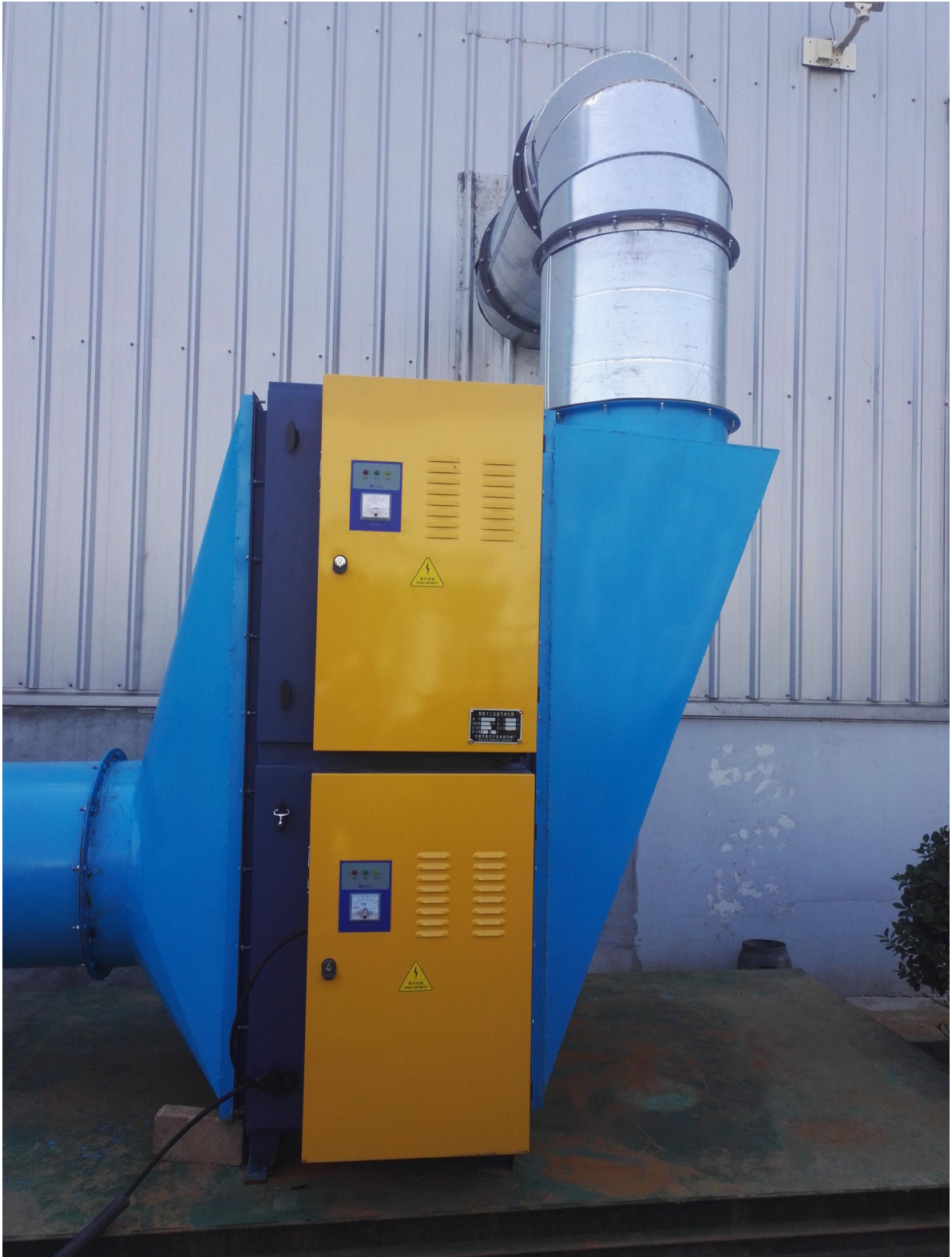
附图 4.6 等离子工业废气净化器（冷轧工序废气排放筒）
