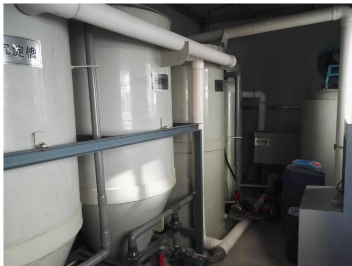
污水处理站内部
