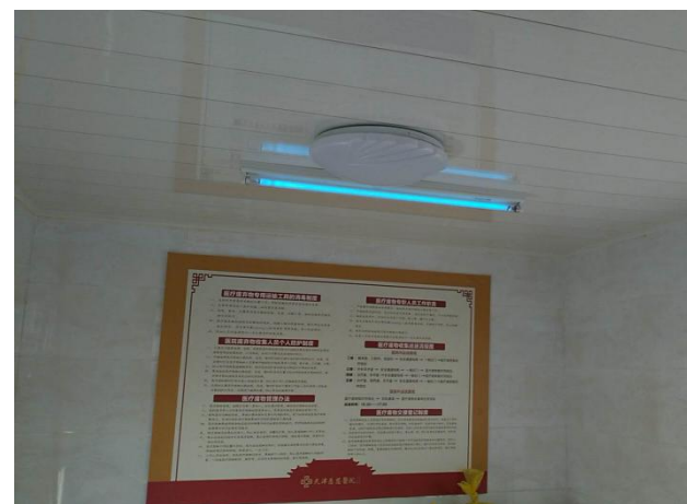
医疗废物暂存处紫外灭菌灯
