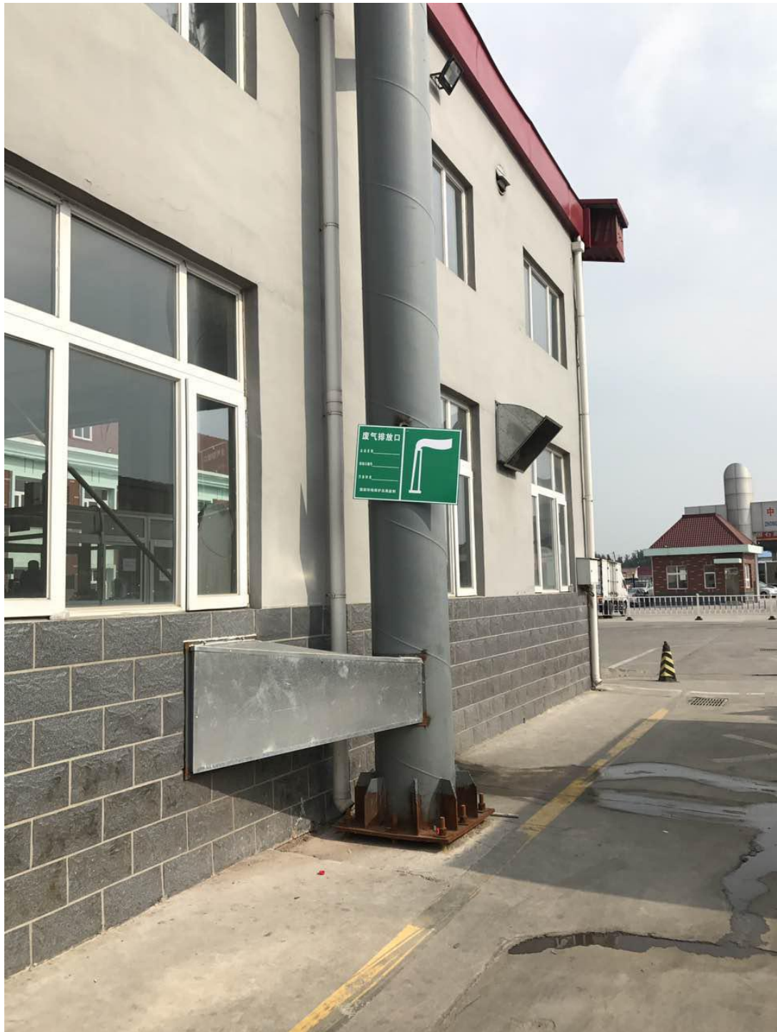
2#车间废气排气筒 P2 及标识牌
