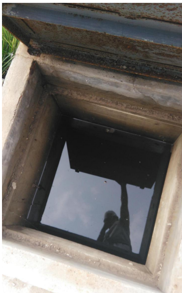
冷凝水收集池
