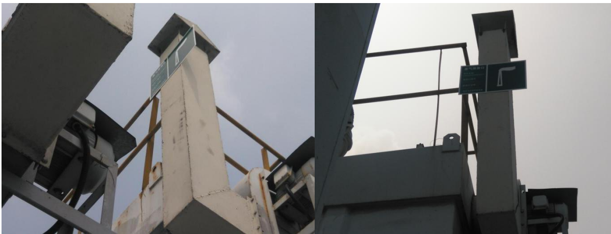
固化粉料仓除尘器排气筒 P5 无机纤维料仓除尘器排气筒 P6
