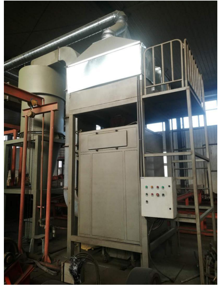
喷涂工序净化设备
