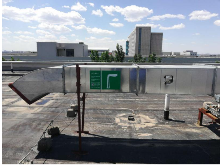
1#油烟净化设施废气排放口
