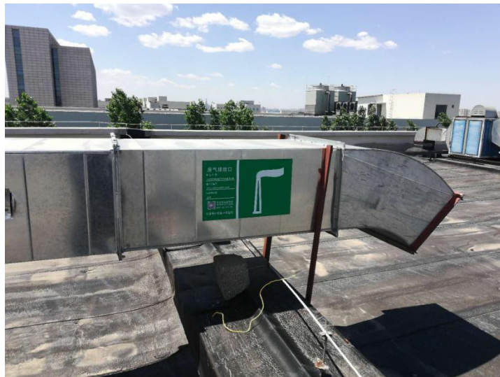
3#油烟净化设施废气排放口
