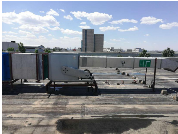
2#油烟净化设施废气排放口
