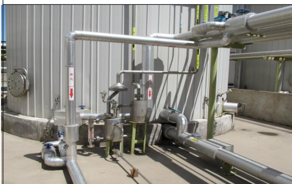
储罐水封装置
