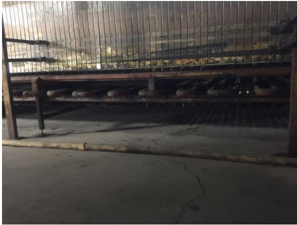
电热水锅炉管道
