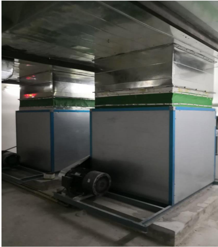
地下排风设备
