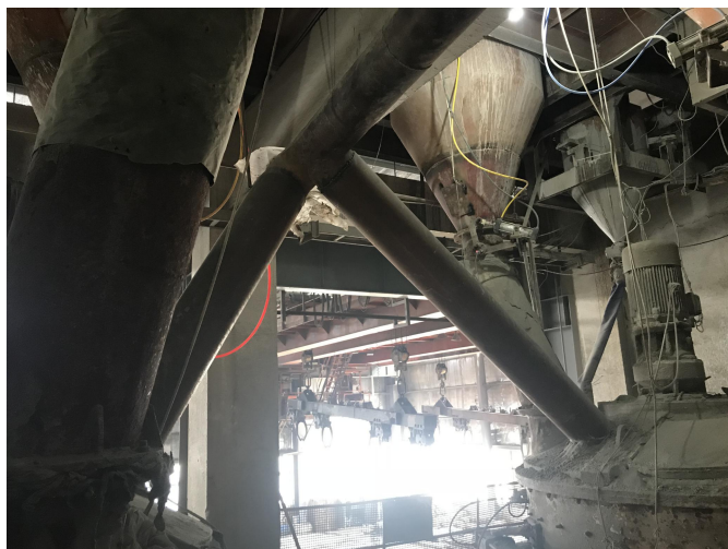
搅拌粉尘集气系统
