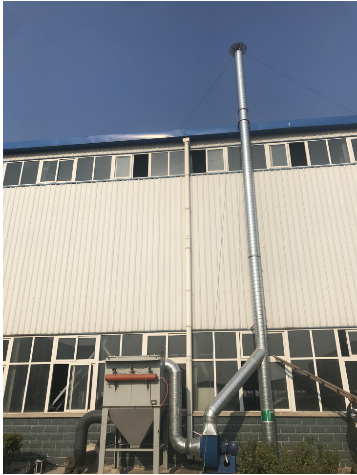
焊接烟尘排放筒
