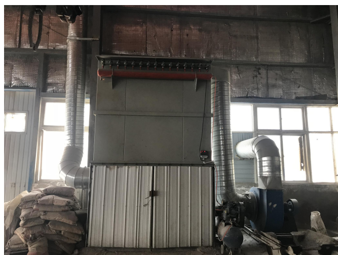
搅拌粉尘净化设施
