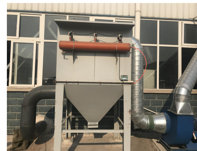
焊接烟尘净化设施
