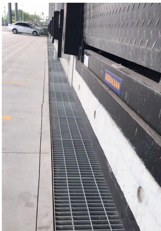
附图 7：消防废水收集排放设施
