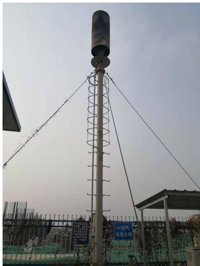
渗滤液处理系统应急焚烧火炬
