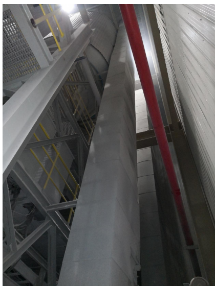
飞灰密闭输送管道
