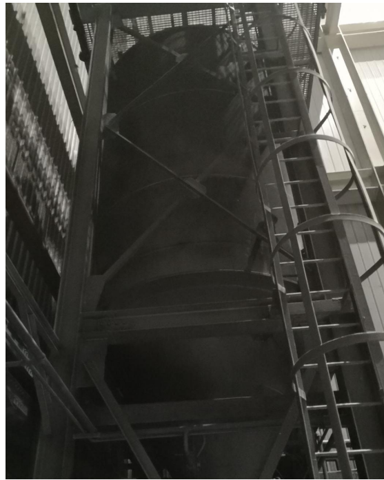
氨水储罐及放空管道
