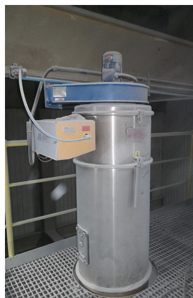
飞灰储罐罐顶除尘器
