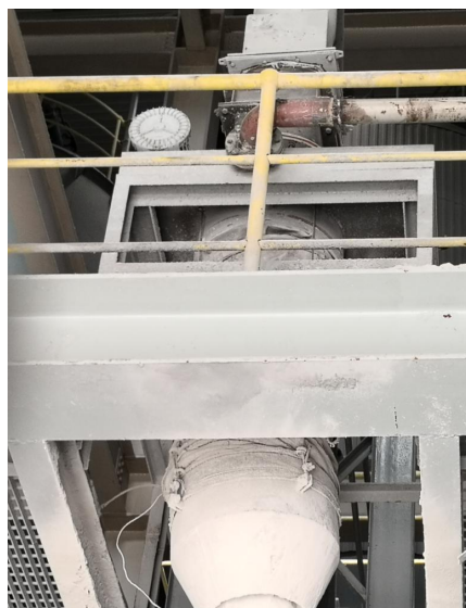
飞灰卸料口集尘装置
