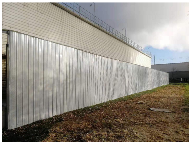
冷却塔隔音屏障
