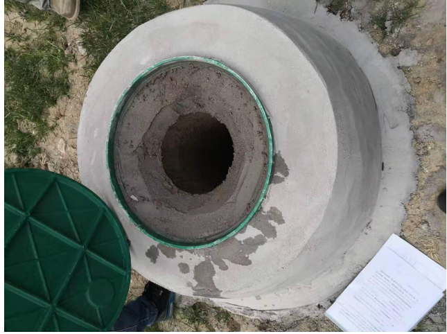
地下水监测井
