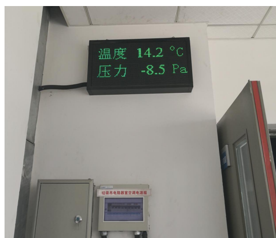
垃圾池负压监控系统
