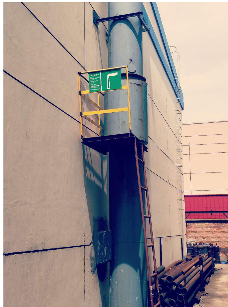
切割、焊接、打磨废气排放筒
