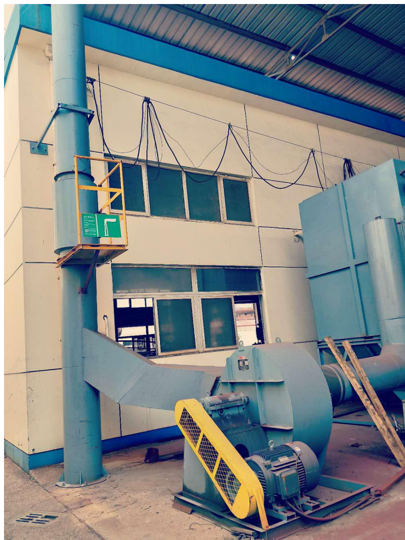
抛光工序废气排放筒
