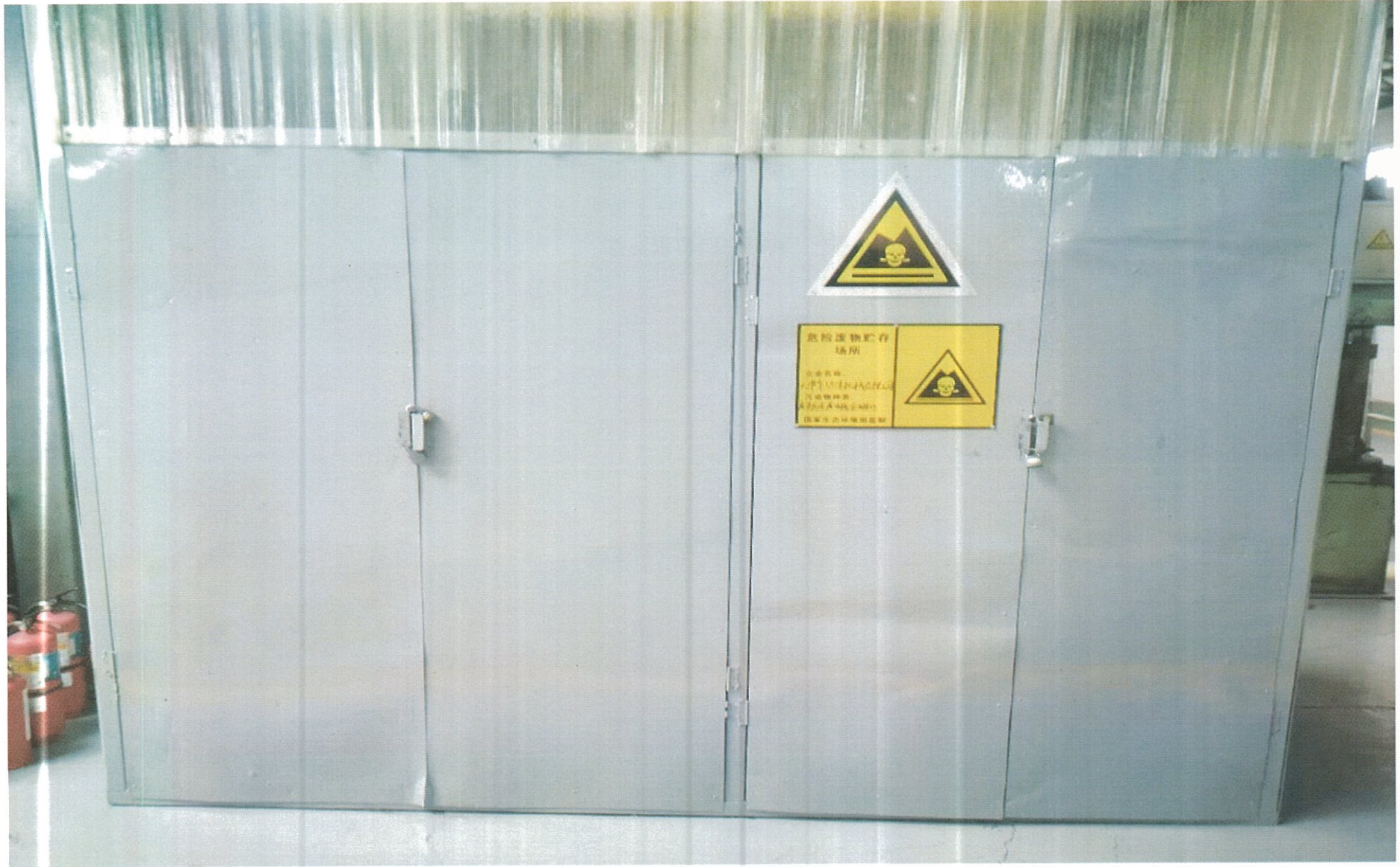
危险废物暂存间规范化
