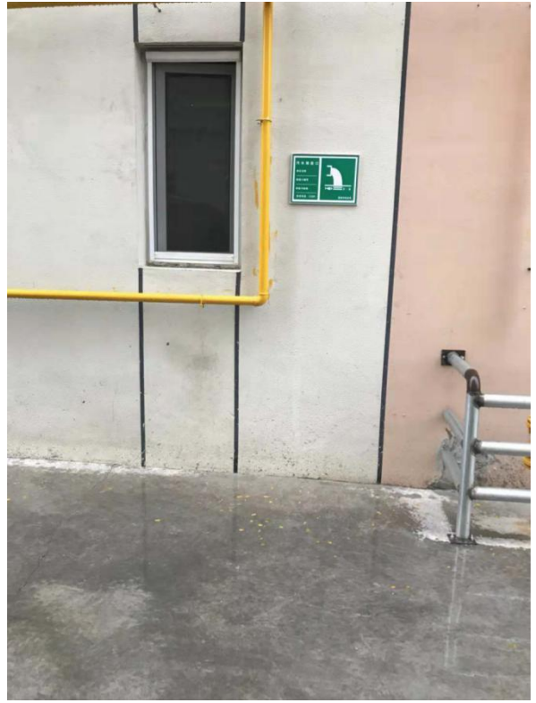
废水排放口标示牌
