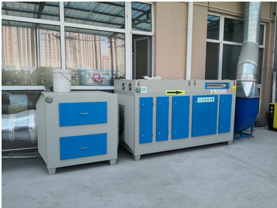
废气净化设备
